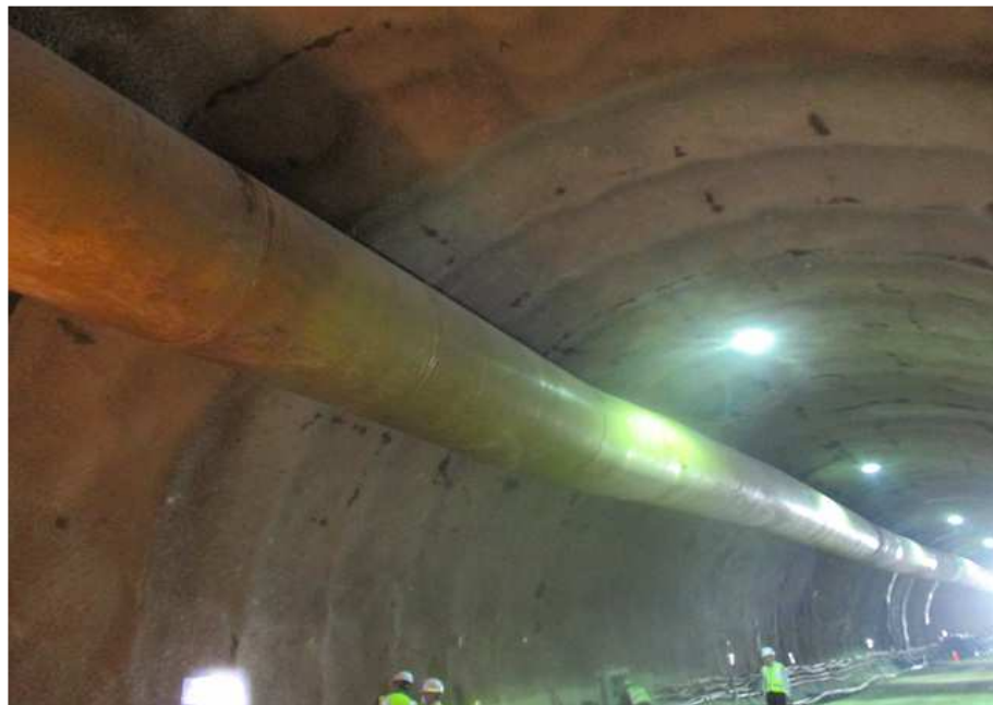
STA 2+475 ~ 2+822 공사중 환기시설 현황
