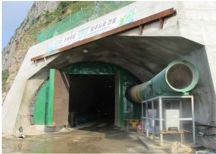
STA 2+475 ~ 2+822 공사중 환기시설 현황
