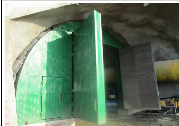
갯구부 방음문 전경
